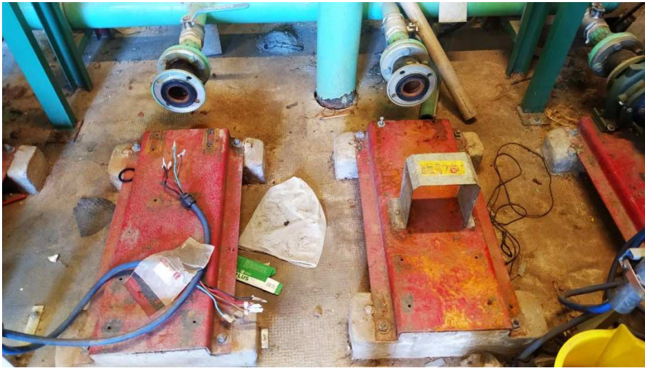
Bomba 2 y 3 - Desinstaladas
