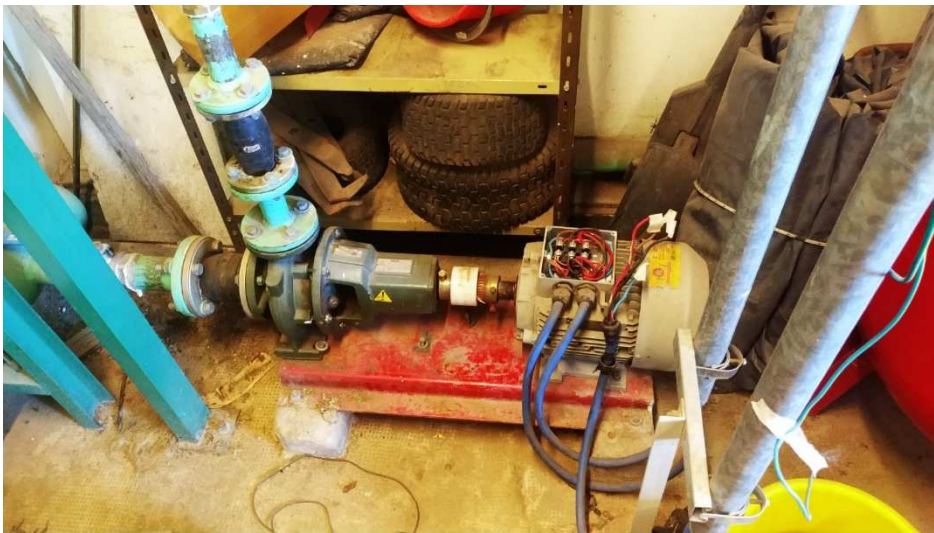
Bomba 4 a reparar
